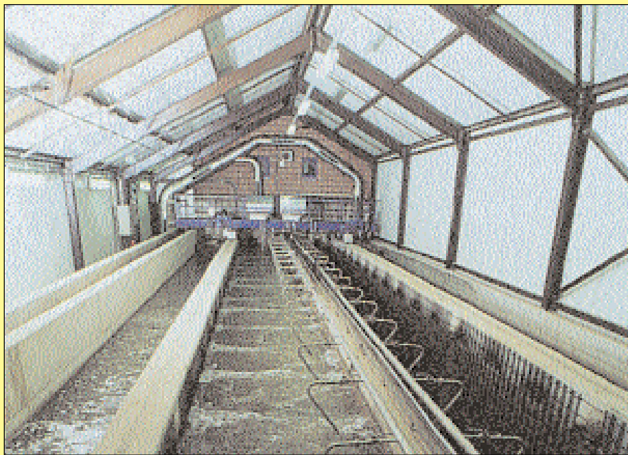
Het gaat om een klassiek biologisch zuiveringsstation met een ontzanding en olieafscheiding (zie foto), drie primaire bezinkingsbekkens en een biologische behandeling. (doc AIDE)
